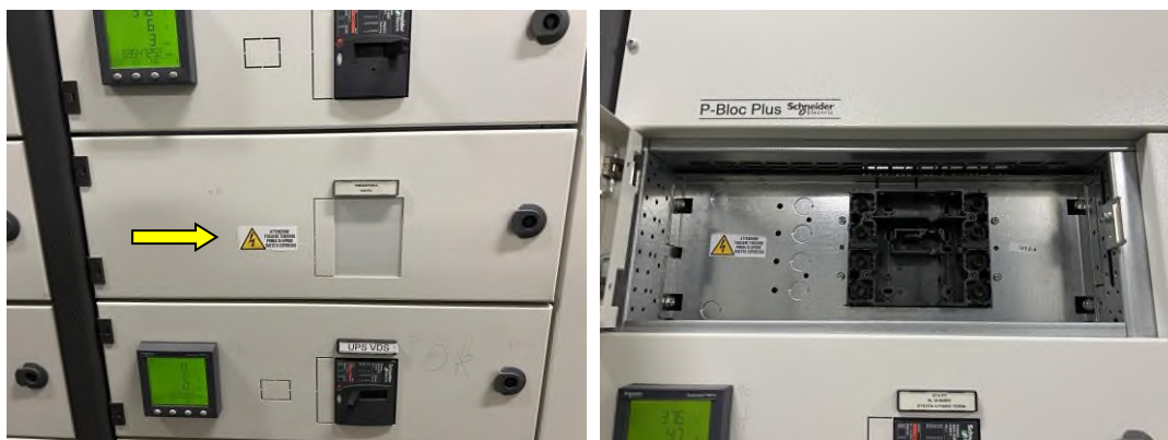
Quadro QGBT cabina MT/Bt "Invariante 7E"
